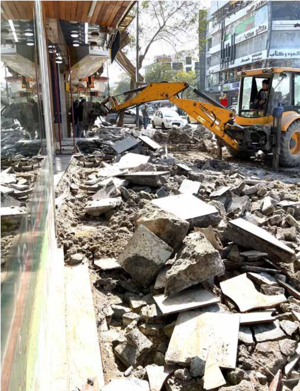
لماذا لاتهتمون بالشوارع وتعالجون حفراها ومطباتها، بدل تكرار أعمال هدم الأرصفة السليمة وبنائها مجدداً؟! أرصفة الكزادة داخل.. خير دليل!
