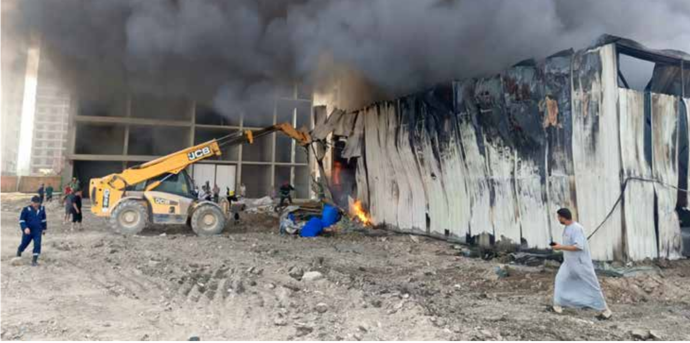
جانب من حريق مجمع سكني قيد الانشاء في بغداد، الجمعة الماضية
