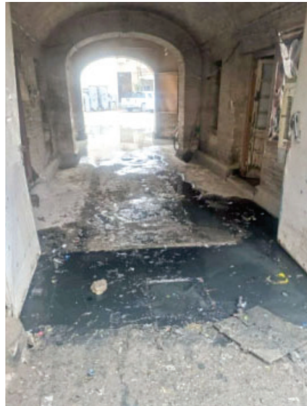
مياه المجاري تغزو أرضية المبنى
